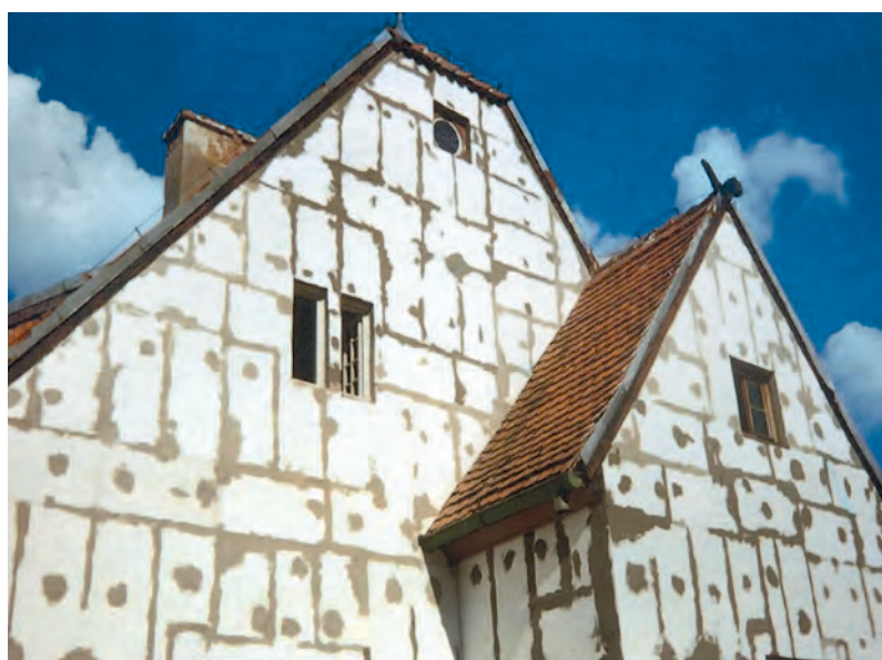
Rysunek 14.3. Szpachlowanie spoin styropianowych i zagłębionych kołków zaprawą klejową prowadzi do powstania mostków termicznych
