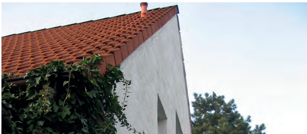
Rysunek 3.4. Brak okapu wystającego poza obrys budynku utrudnia zaizolowanie ściany szczytowej
