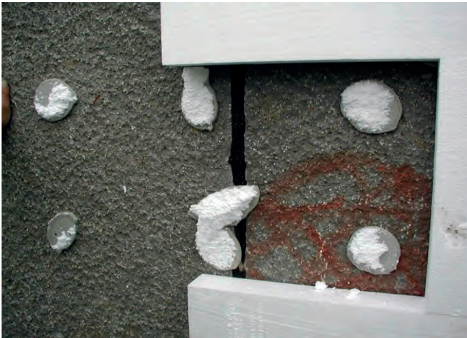
Rysunek 14.1. Brak kleju na obwodzie płyt
