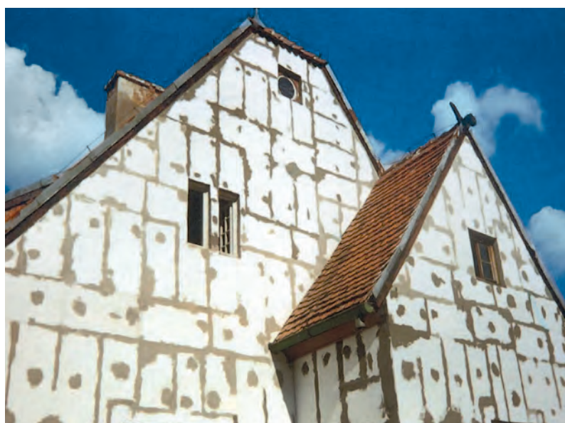
Rysunek 14.3. Szpachlowanie spoin styropianowych i zagłębionych kołków zaprawą klejową prowadzi do powstania mostków termicznych
